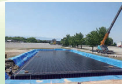
▲雨水貯留施設
